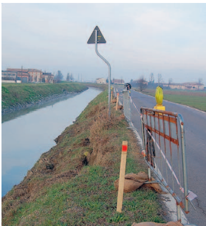
Naviglio Da lunedì i lavori all'argine franato.
